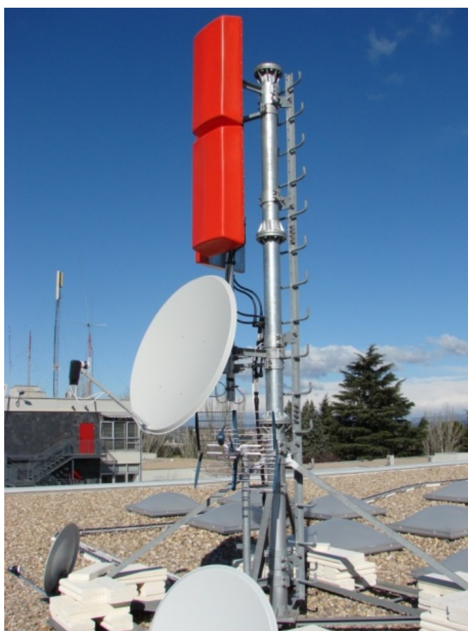
Figura 9. Sistema radiante empleado en las pruebas de emisión de DVB-T2 de la Cátedra
