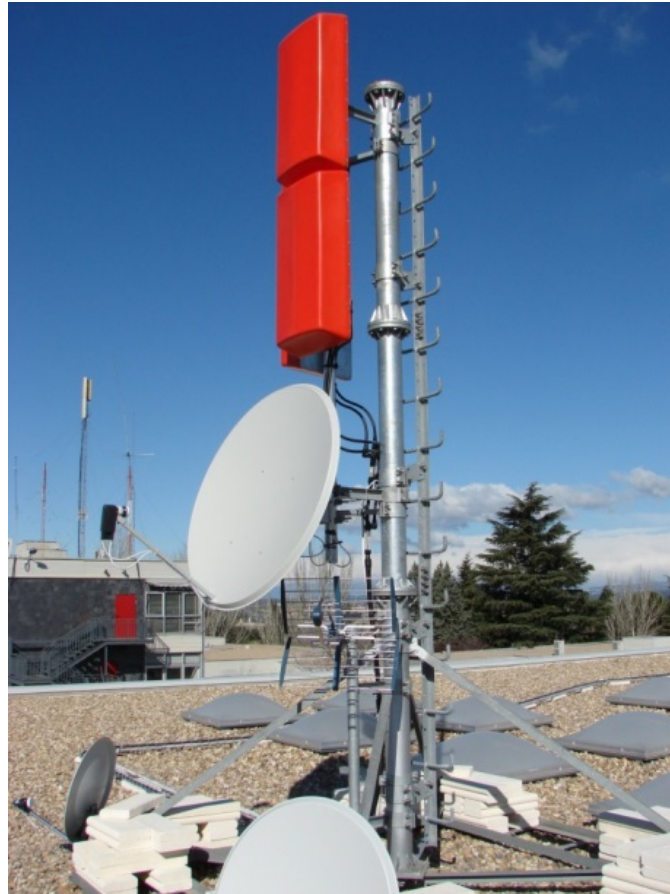
Figura 8. Sistema radiante empleado en las pruebas de emisión de DVB-T2 de la Cátedra.
